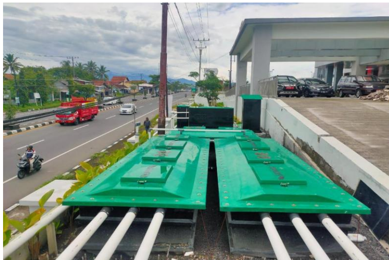
Gambar 2.23 Dokumentasil Instalasi IPAL UPTD RSD Merah Putih Tahun 2020
