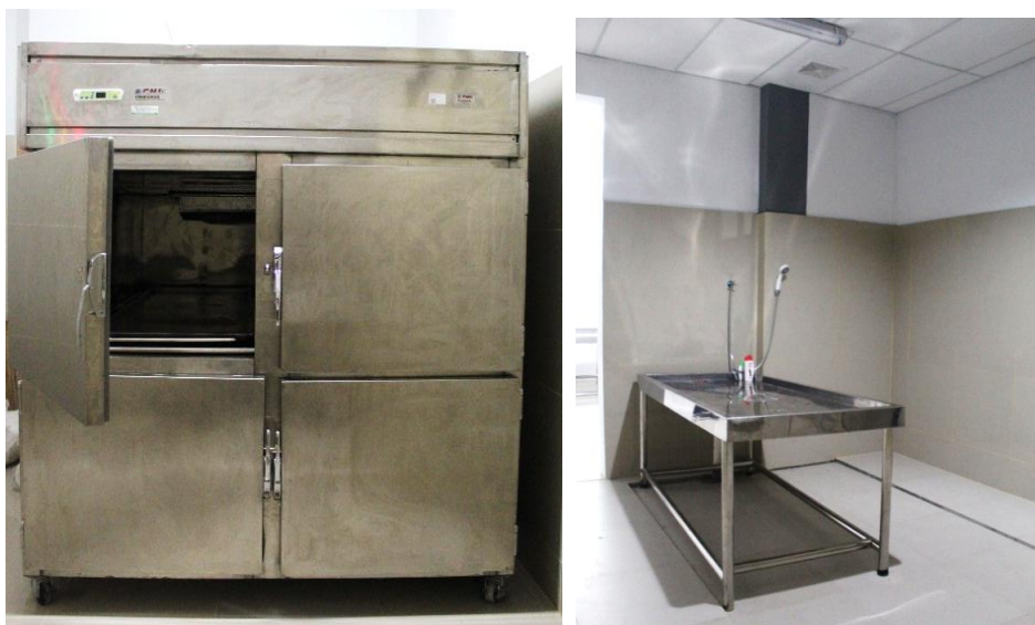
Gambar 2.24 Dokumentasi Instalasi Pemulasaran Jenazah UPTD RSD Merah Putih Tahun 2020
