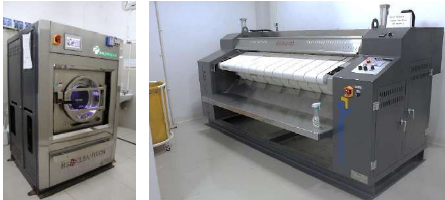
Gambar 2.20 Peralatan di Instalasi Laundry di RSD Merah Putih Tahun 2021
