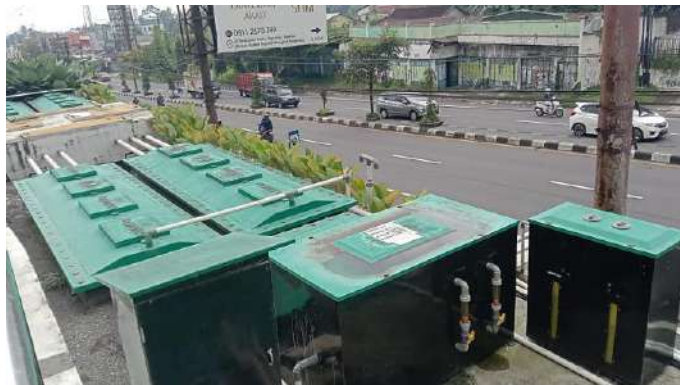
Gambar 2.22 Instalasi IPAL di RSD Merah Putih Tahun 2021
